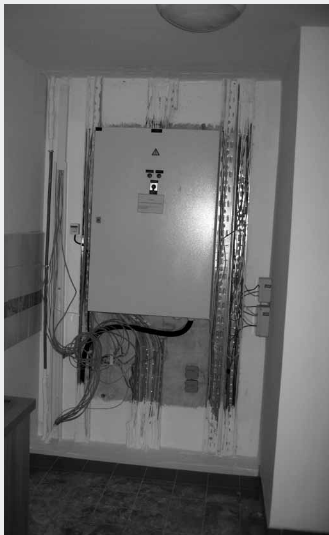
Videz razdelilnika v nadstropju s protipožarno tesnitvijo prehodov
