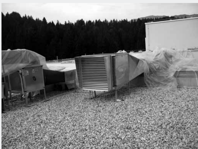
Sistemi prezračevanja na strehi objekta
