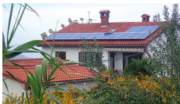
Sončna elektrarna v Izoli z močjo 3,01 kWp
