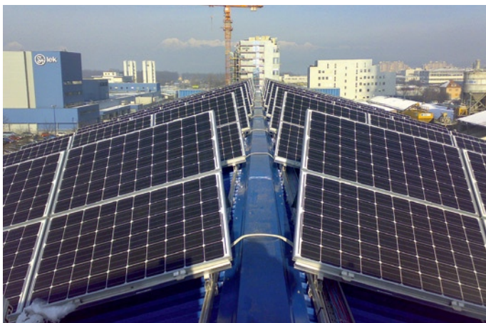
Sončna elektrarna na strehi podjetja Energetika Ljubljana, z močjo 77, 28 kWp
